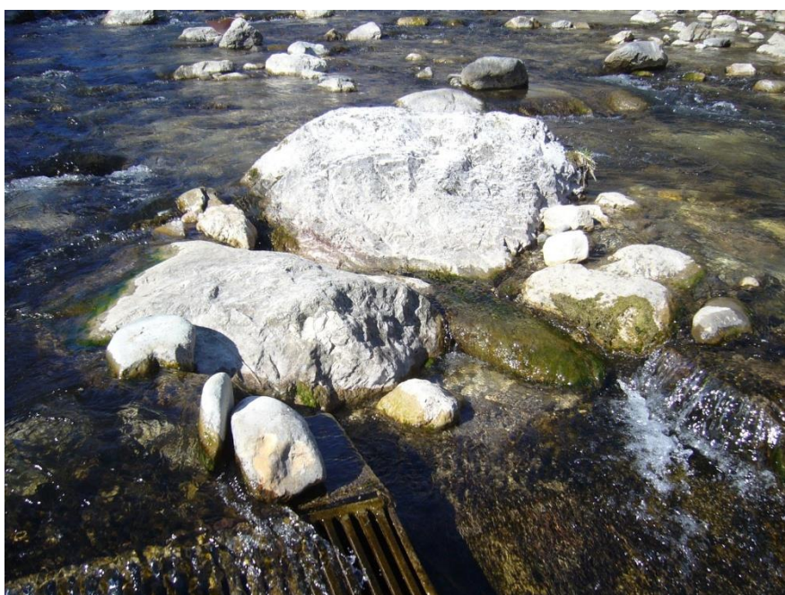
Preso impianto Maè Zoldo Energy: grossi massi occludono parzialmente il lume del rilascio del DMV
